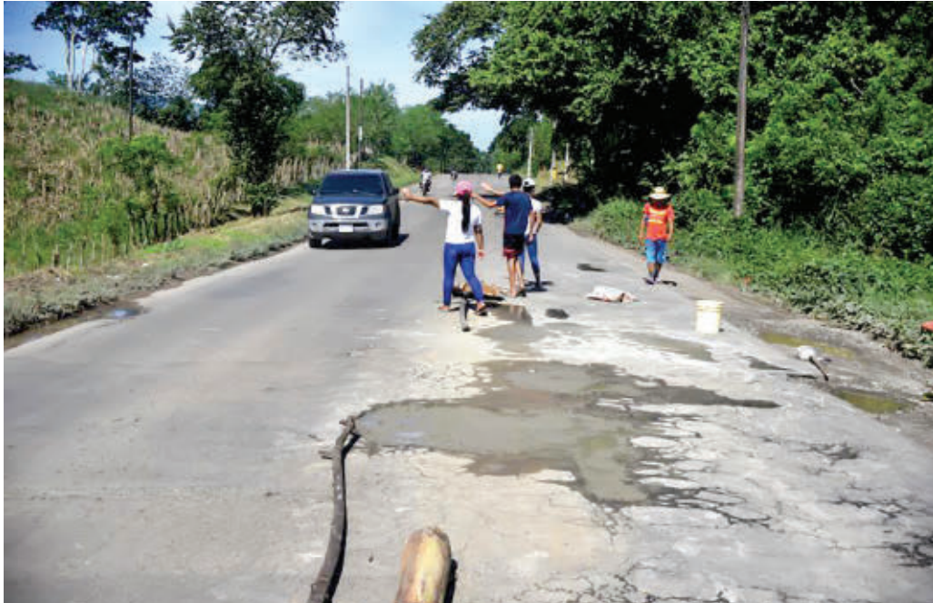
INFRAESTRUCTURA. La carretera CA-13 entre La Ceiba y Trujillo está severamente dañada.
