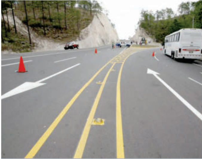
CARRETERA. Gracias a fondos de la Cuenta del Milenio, Honduras pudo reconstruir y ampliar la importante CA-5.
