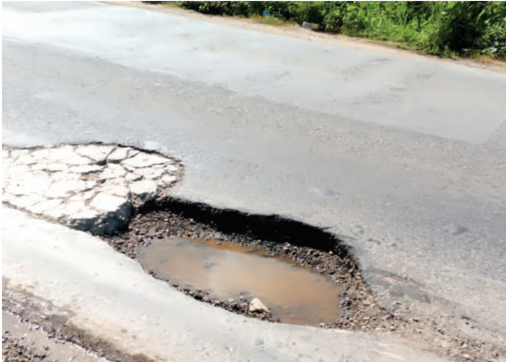
PELIGRO. Enormes cráteres han inundado la carretera entre Tela y El Progreso.
