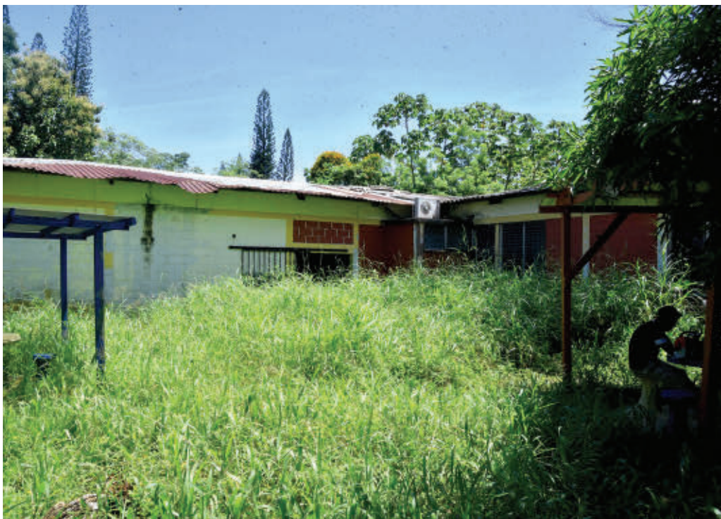
ABANDONO. El Curla se fundó en mayo de 1967, actualmente los edificios están a punto de colapsar.
